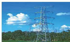
山东电力智能电网配网
