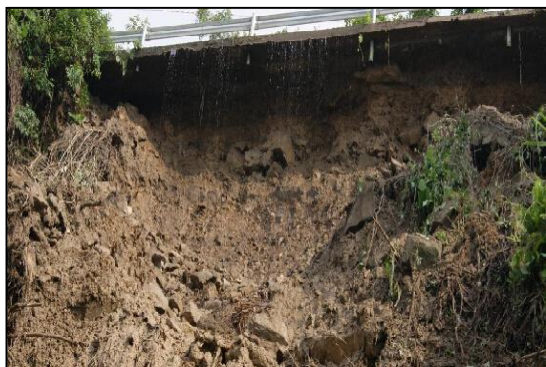
图 1-1 强降雨引起路基边坡滑塌
