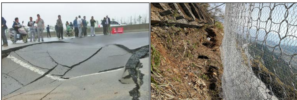
图 1-3 回填压实不足引起路面坍塌
