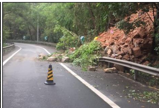
图 1-2 岩质边坡崩塌滚石
