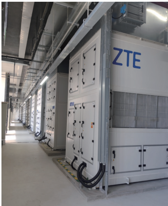
建设银行和林格尔数据中心间接蒸发冷却空调项目实景
