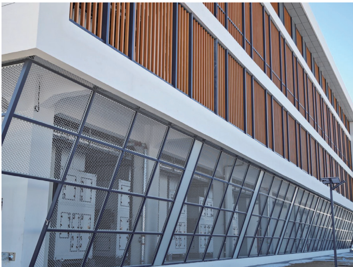
乌兰察布中国银保信数据中心稳定运行的间接蒸发冷却空调
