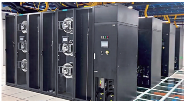
▲ 图2 中国电信浙江金华数据中心液冷机房
