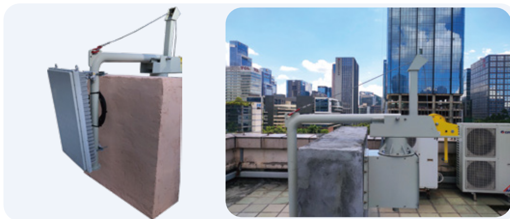
图2 女儿墙外挂AAU支架 ▶
