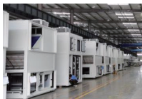
中国建设银行 间接蒸发冷却空调
